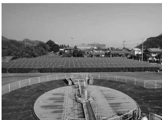
太陽光発電設備（渡瀬浄化センター）
