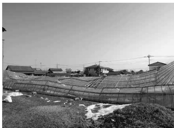
ハウス倒壊現場
